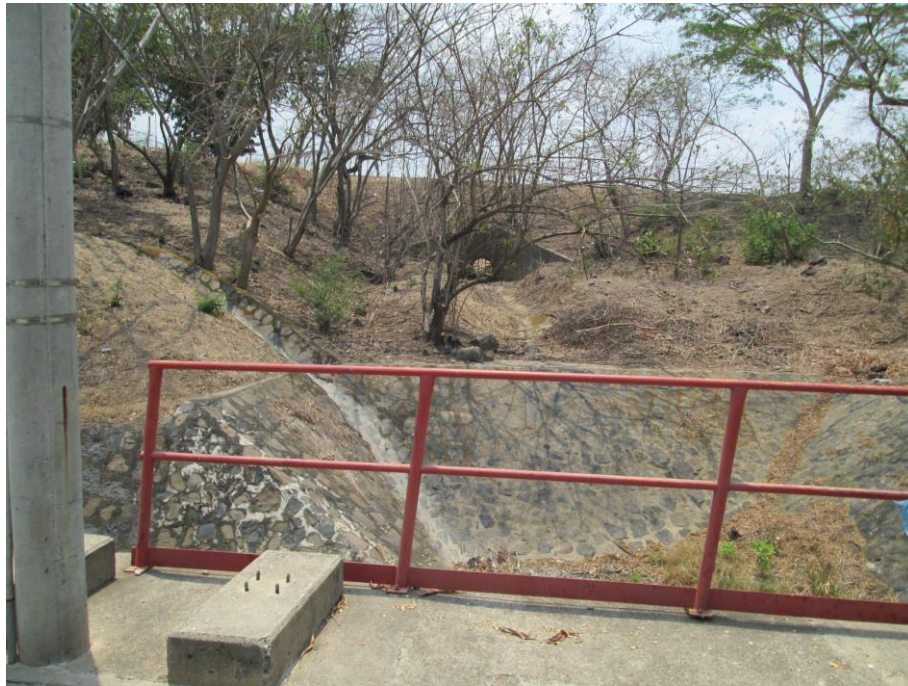
Figura 10. Obra de drenaje actual, a corregir rasante y punto de evacuación
