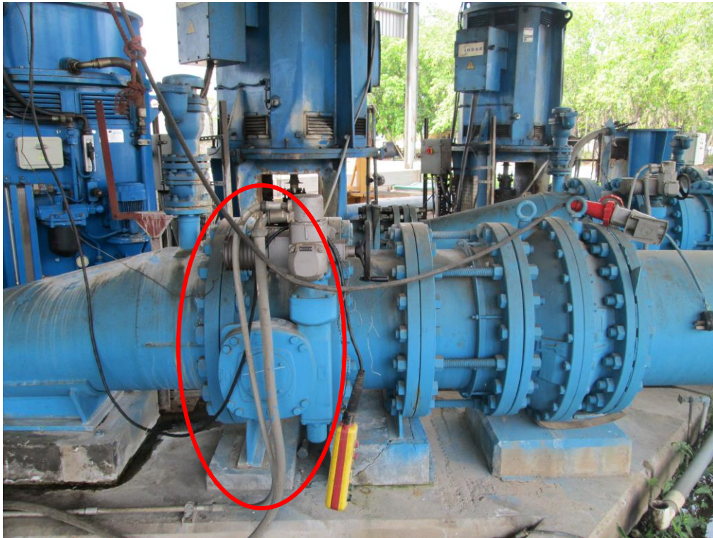
Ilustración 3. Vista de la ubicación actual de válvula motorizada en EB-1.
