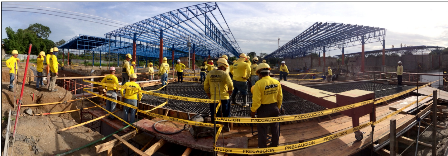
Panorámica del colado de concreto hidráulico del techo del túnel peatonal correspondiente a uno de los viales que tendrá la Terminal de Integración del SITRAMSS, obra esencial para el avance de la construcción de la edificación.
