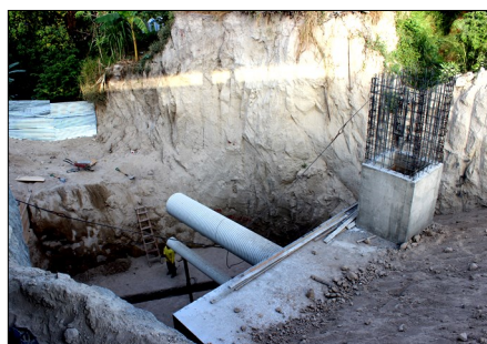
Construcción de caja de captación de aguas lluvias, costado norponiente de la Terminal de Integración.
