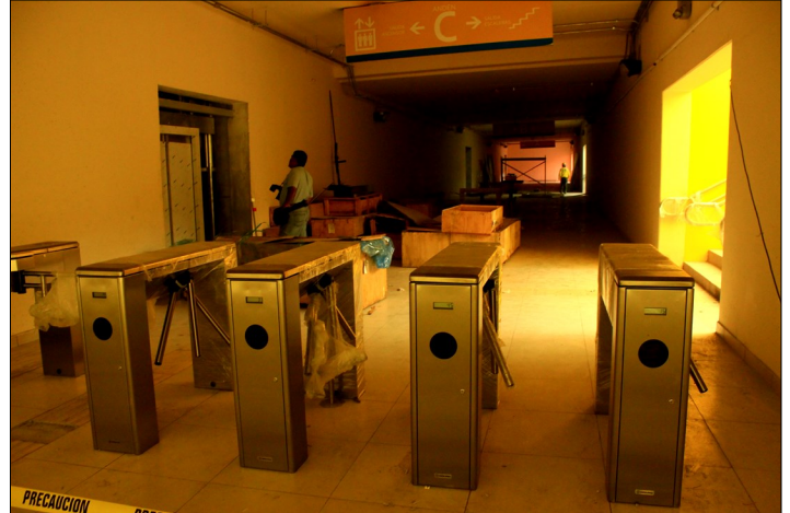
Molinetes electrónicos en el interior del túnel peatonal.
