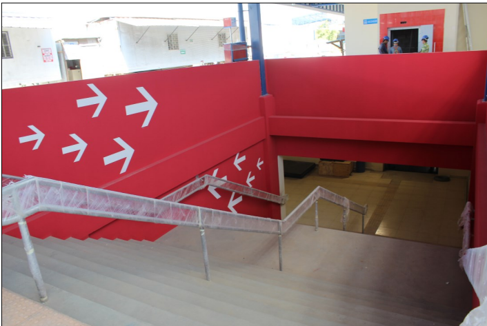
Gradas de acceso al túnel peatonal que conduce a los andenes para abordaje de autobuses.
