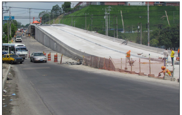
Paso Superior de la intersección de la 50 Ave. Nte. y Bulevar Castellanos
