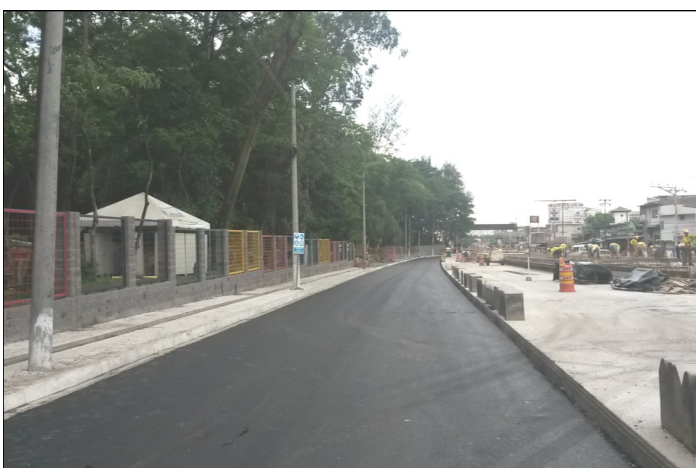
Colocación de la carpeta asfáltica en el carril particular frente al Parque Infantil, donde también se construye una Estación de Buses.
