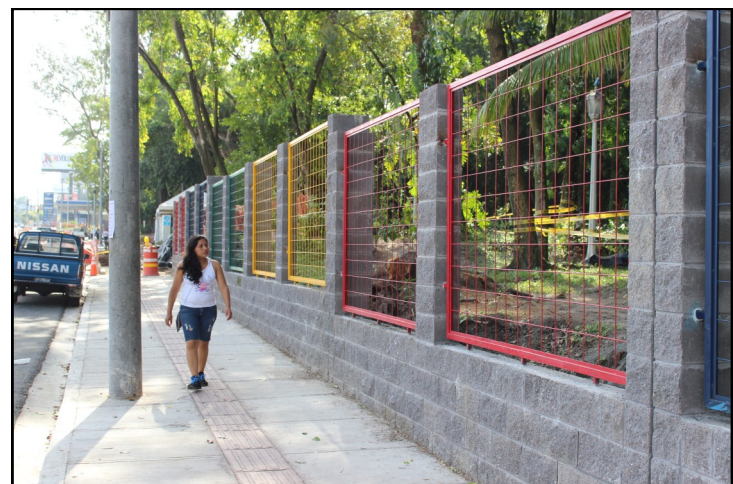
El muro perimetral está casi concluido así como la acera con su señalética para no videntes, está pendiente de construir unos 50 metros que es donde se construirá la entrada principal, junto al edificio de la administración y el museo de la ciudad.
