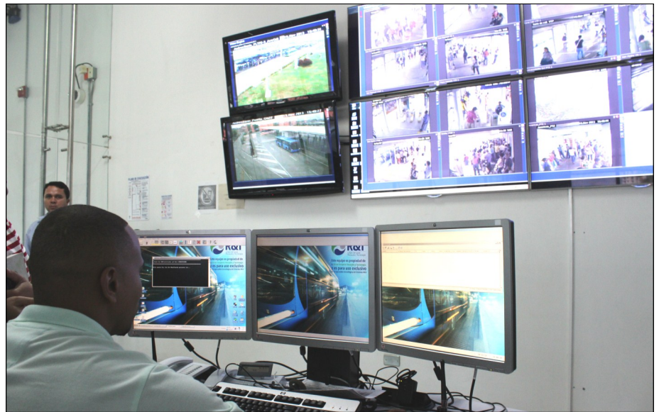
Centro de Control de Metro Cali en Colombia que monitorea la operación de 850 autobuses en el sistema de transporte BRT MÍO, que funciona en una estación de ferrocarril considerada patrimonio cultural.
