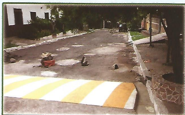
Construcción de Túmulo frente a las Instalaciones del Instituto Salvadoreño del Seguro Social, Barrio Nueva España
