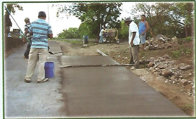
Concreteado Hidráulico de tramo de calle que conduce a cancha en Caserío Las Lilas
