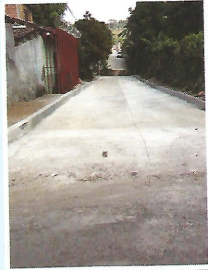
Construcción de Concreto Hidráulico en Tramo de la 4° Calle Poniente que intercepta con la 5° Av. Sur, Barrio El Calvario (54 mts. Lineales)
