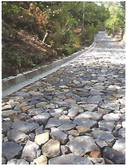
Construcción de Empedrado seco en calle conocida como La Bombeada hasta el alto donde don Eusebio Araniva. (200 mts. Lineales) MONTO $39,436.01
