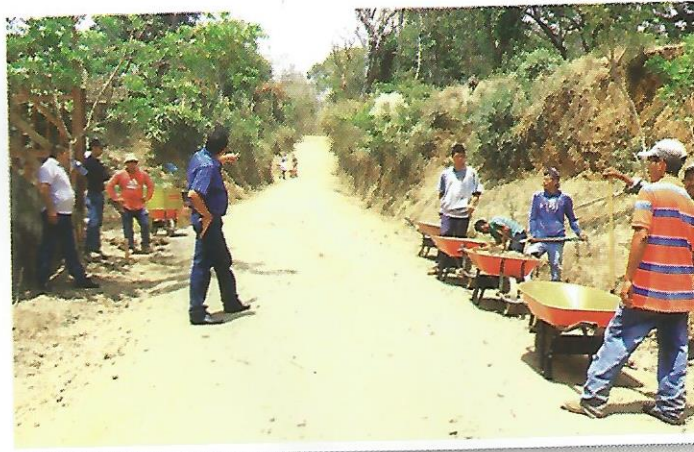
Construcción de Empedrado Fraguado en la Cuesta de Los Linos, Cantón Copinol Segundo (160 mts. Lineales)
