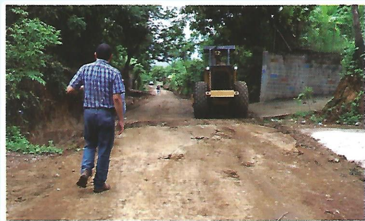
Conformación y Balastado de tres tramos de calle en Cantón Las Mesas (1480 mts. Lineales) MONTO $38,100.91
