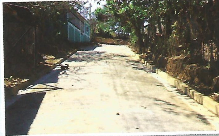
Construcción de Concreto Hidráulico en Tramo de Calle de la Colonia Santa Rosa, Cantón Las Marías (147.10 mts. Lineales)
