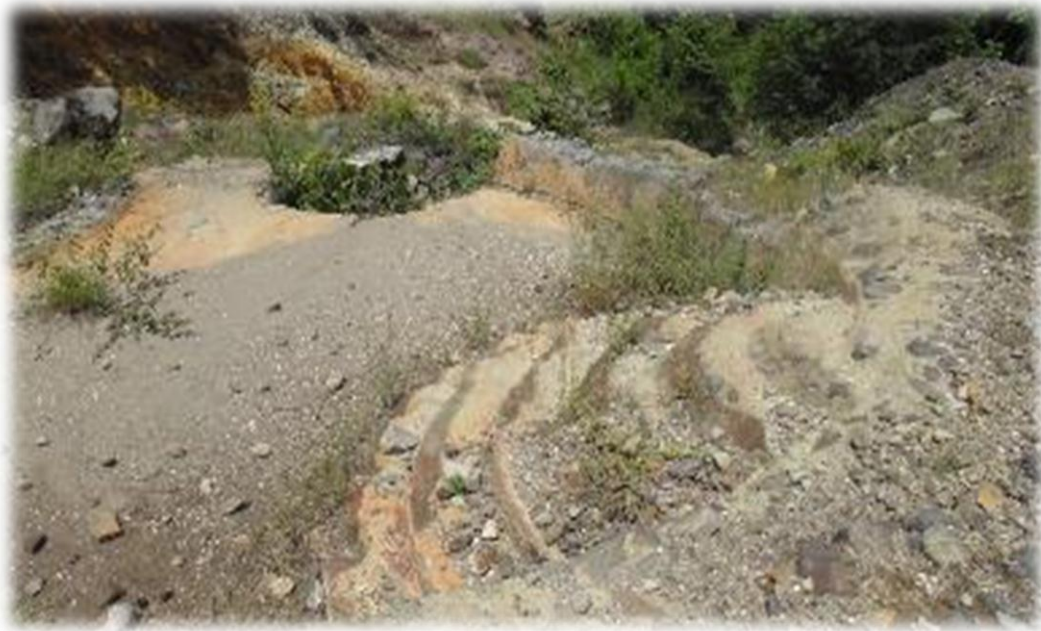
Imagen de destrucción en Centro Turístico Los Infiernillos después de la tormenta 12-E
