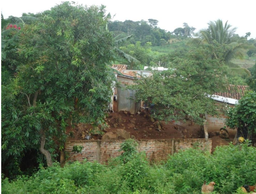
Ilustración 6. Riesgo de derrumbe en Colonia Helen.
