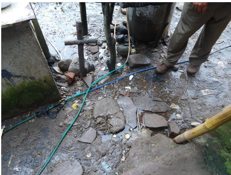
Ilustración 8. Nacimiento de agua en piso de las viviendas de La Colonia El Triunfo, Zona Verde
