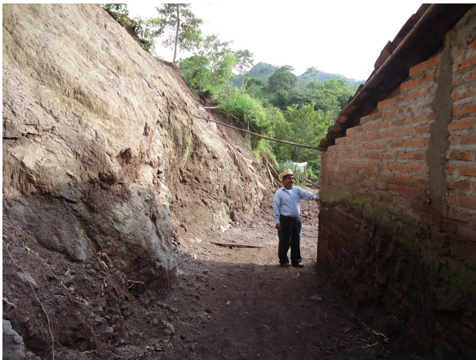
Ilustración 7. Zona de derrumbe y deslizamiento en el Cantón Sitio Viejo, Caserío Sayulapa
