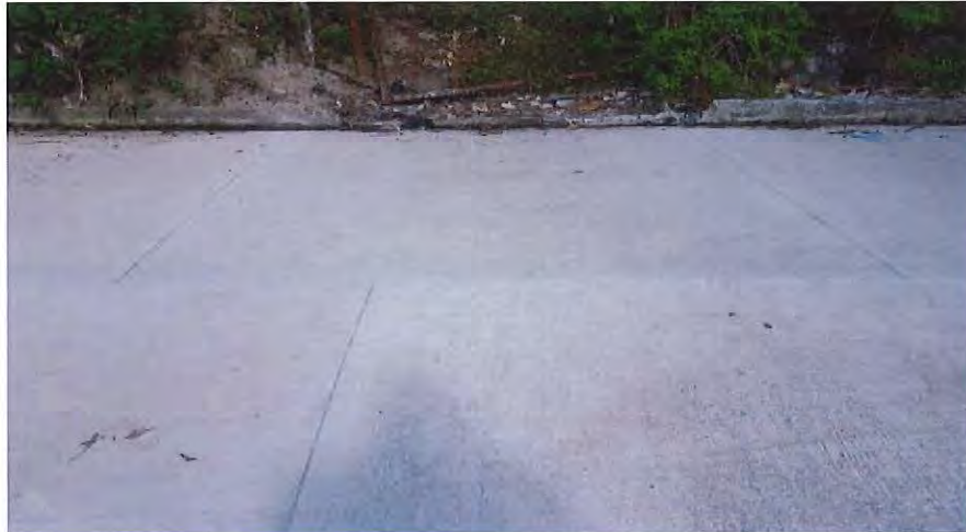
Imagen 1. Muestra el buen estado de la capa de rodadura al momento de recepción del proyecto.
