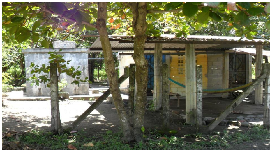
Figura 3: Sistema de bombeo de agua con el que se abastece el cantón El Porvenir.
