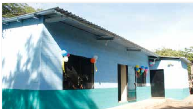
Construcción de casa comunal en comunidad Madre Tierra, cantón San Fernando, sector Centro.
