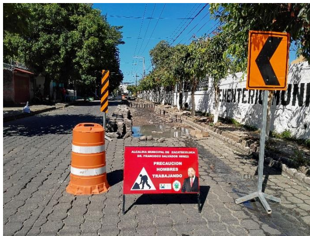
PAVIMENTACION DE TRAMO DE CALLE GRAL. RAFAEL OSORIO E INSTALACION DE TUBERIAS DE AGUAS NEGRAS.
