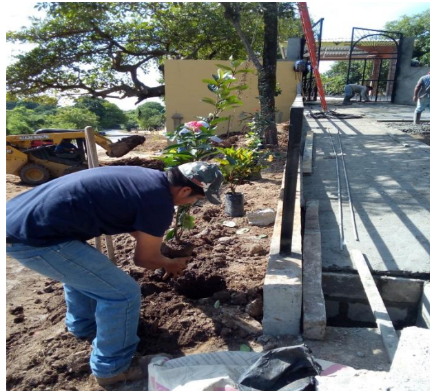
Siembra de arbolitos en cementerio municipal
