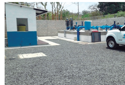
Mejoramiento del sistema de agua potable del sector Norponiente del municipio de Apopa, Etapa 1
