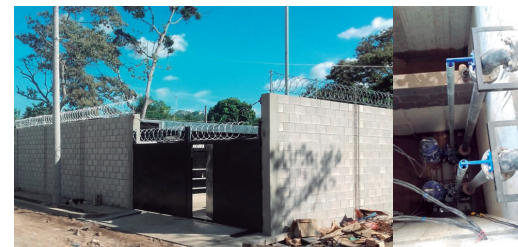
Construcción de letrinas y sistemas de disposición de aguas grises en comunidades de Santa Ana.
