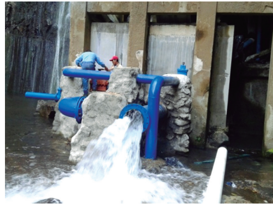
Vista de captación Talcomunca.
