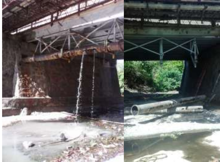
Daños en colector
