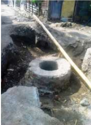
Pozo de visita en mal estado
