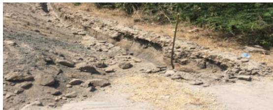
Material no adecuado para compactar
