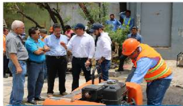
ANDA inicia plan intensivo de reducción de fugas y eliminación de baches dejados por reparaciones
