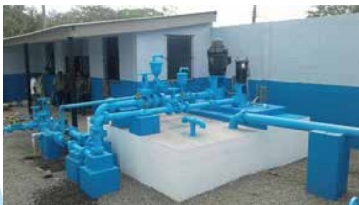
Cisterna y rebombeos
