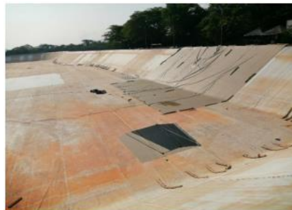
Limpeza de taludes y fondo del reservorio, colocación y soldadura de Geomembrana
