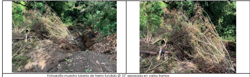
Fotografía muestra tubería de hierro fundido Ø 10" separada en varios tramos
