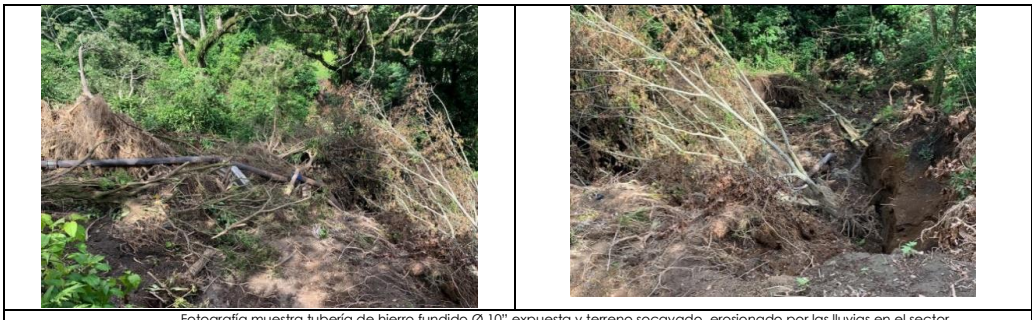
Fotografía muestra tubería de hierro fundido Ø 10" expuesta y terreno socavado, erosionado por las lluvias en el sector
