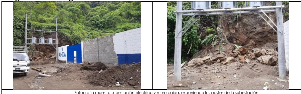
Fotografía muestra subestación eléctrica y muro caído, exponiendo los postes de la subestación
