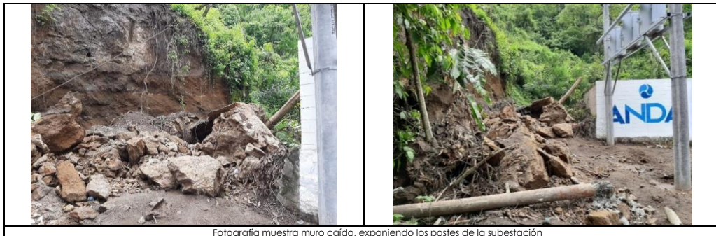
Fotografía muestra muro caído, exponiendo los postes de la subestación
