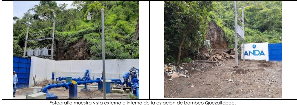
Fotografía muestra vista externa e interna de la estación de bombeo Quezaltepec.
