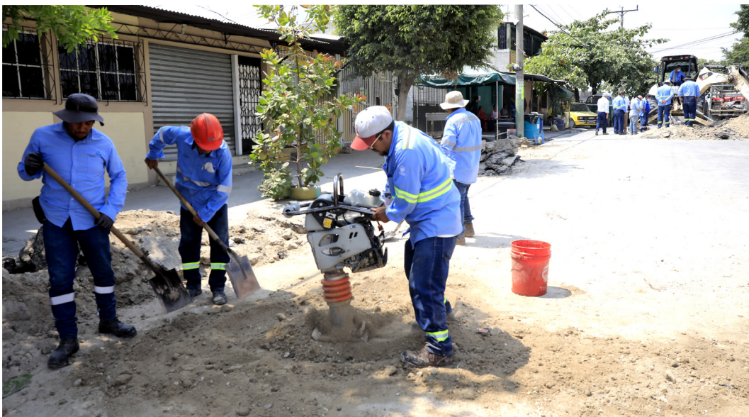
Reparaciones realizadas en redes de acueducto proyecto Sierra Morena Fotografía: Willian Carranza
