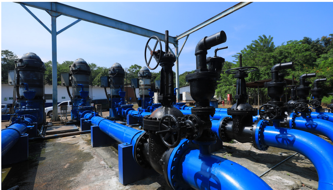
Equipos de bombeo nuevos de 2,000 kw. Fotografía: Willian Carranza
