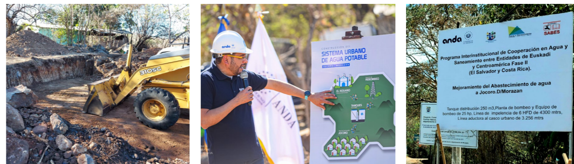
Colocación de primera piedra en Proyecto Jocoro en proyecto que abastecerá a mas de 6000 habitantes Fotografías de Archivo
