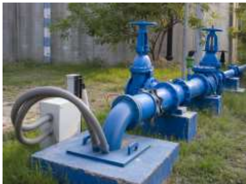
EQUIPO DE BOMBEO - MEJICANOS
