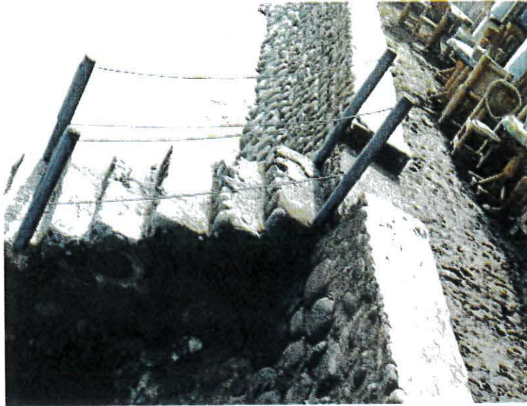
Figura 3. Condición del muro de protección contra el oleaje.
