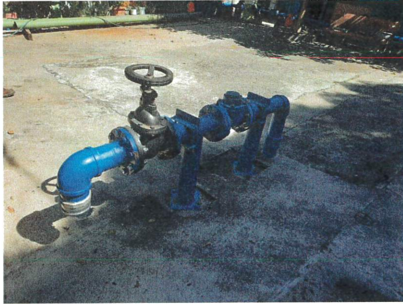
Válvulas de pozo #1, de la Desarrolladora Madreselva S.A de C.V.
