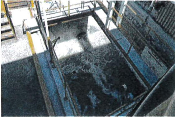
Figura 3. Tanque homogeneizador de aguas residuales
