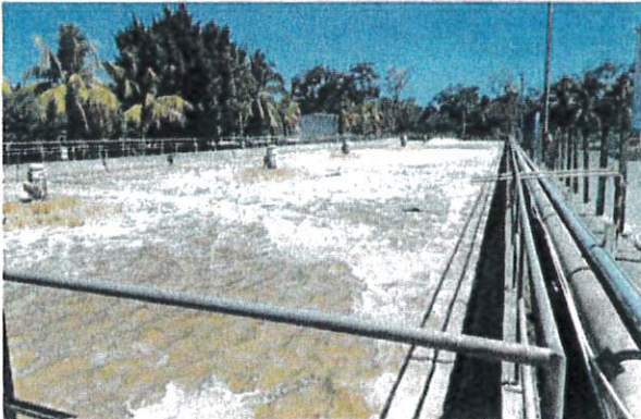
Figura 5. Tanque de aireación de lodos activados.
