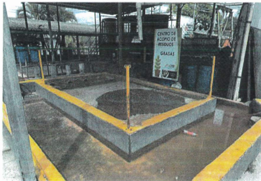
Ilustración 2. Ingreso de aguas residuales a la PTAR
