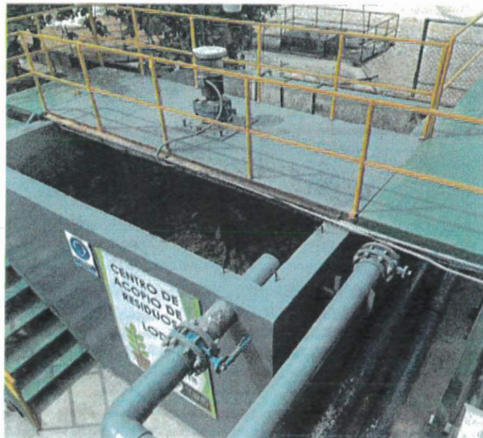
Ilustración 6. Almacenamiento de Lodos deshidratados
