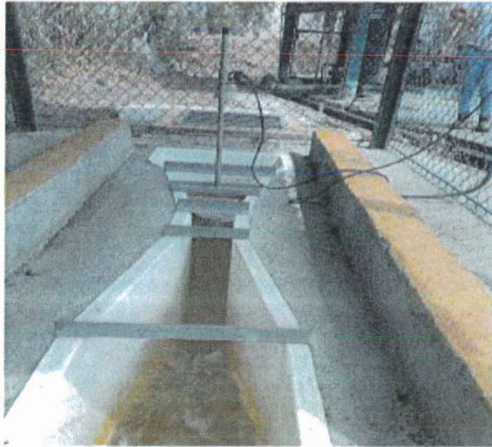
Ilustración 5. Canaleta Parshall. Medición de Caudal
