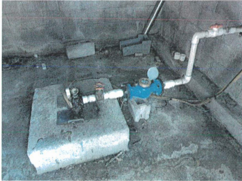
Instalaciones del pozo en el proyecto "Granja Avícola Santa Lucía"
