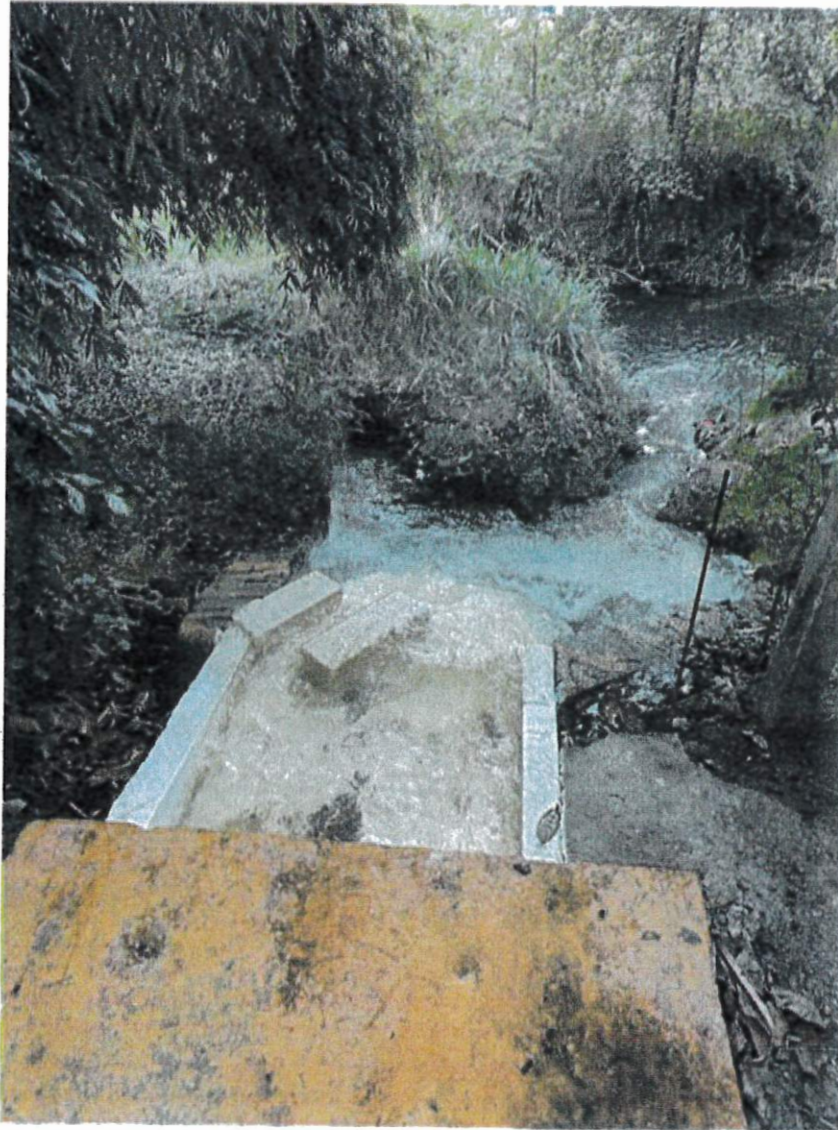
Ilustración 7. Descarga de aguas residuales al medio receptor.
