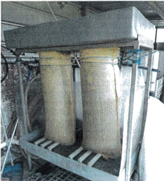
Figura 3. Filtros de manda de secado de lodos residuales.
