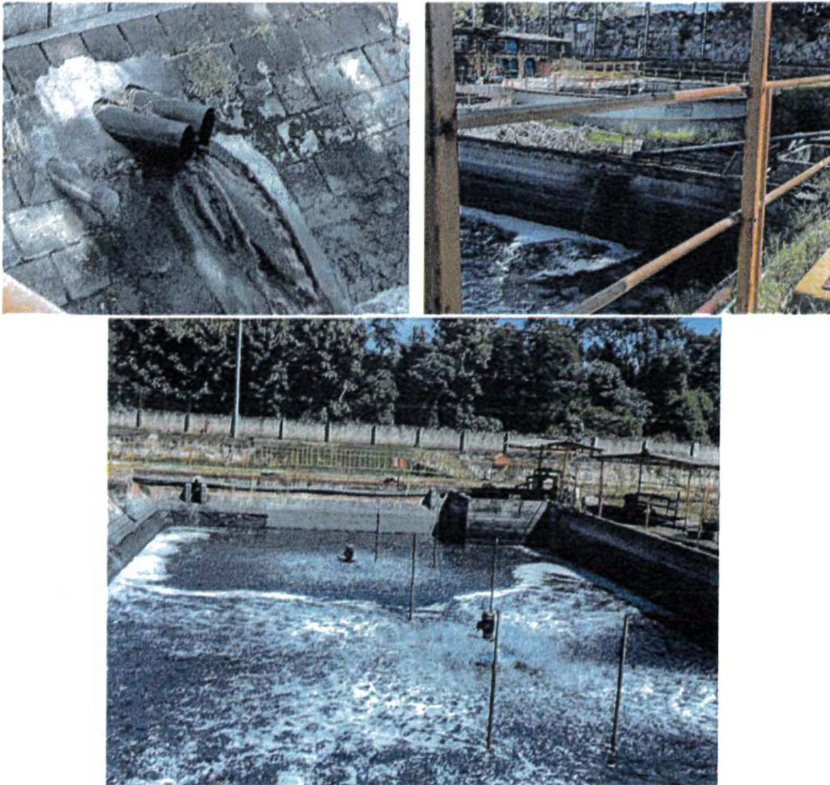
Figuro 3. Ingreso de aguas residuales especiales, ordinarias y lixiviados al tanque de homogenización.
