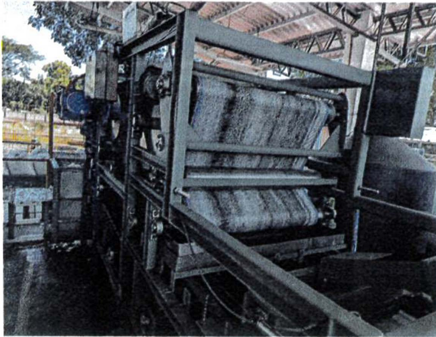
Figura 8. Estación de deshidratación de lodos.
