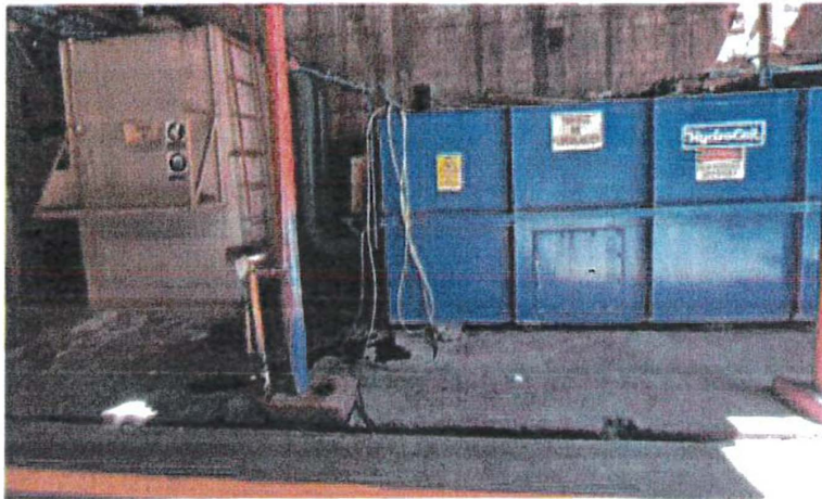
Ilustración 8. PTAR Back Up. Tanque de Mezcla Rápida y Tanque de Floculación
