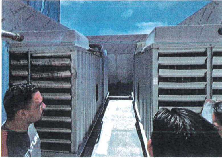
Ilustración 3. Torres de enfriamiento. PTAR Principal
