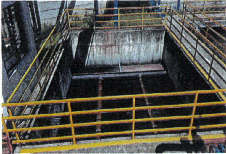
Ilustración 5. Clarificador secundario. PTAR Principal
