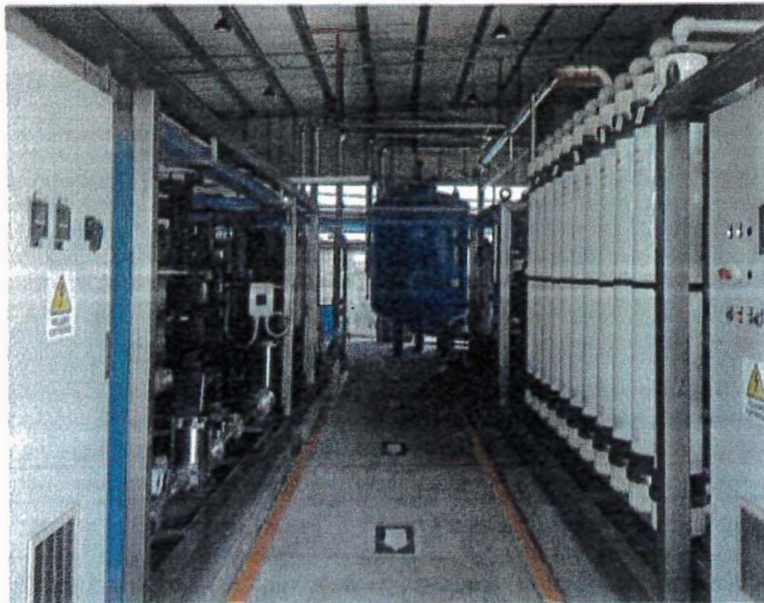
Ilustración 6. Sistema de tratamiento de aguas residuales para reutilización.
