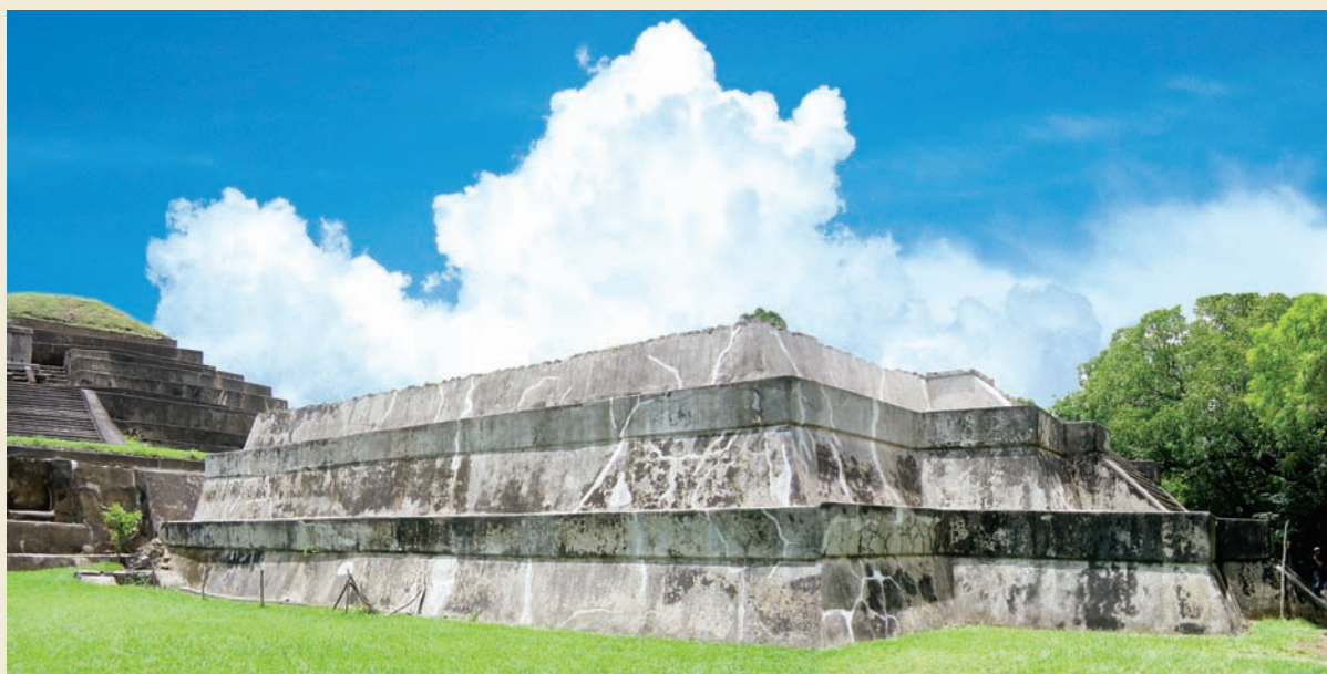
Fachada norte del basamento. Vista general de la restauración con cemento. El área afectada fue similar a la expuesta en la fotografía. Fotografía: Shinya Kato
