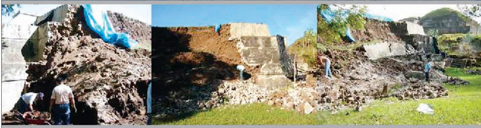
Tazumal. Fotos del derrumbe de la estructura B1-2
