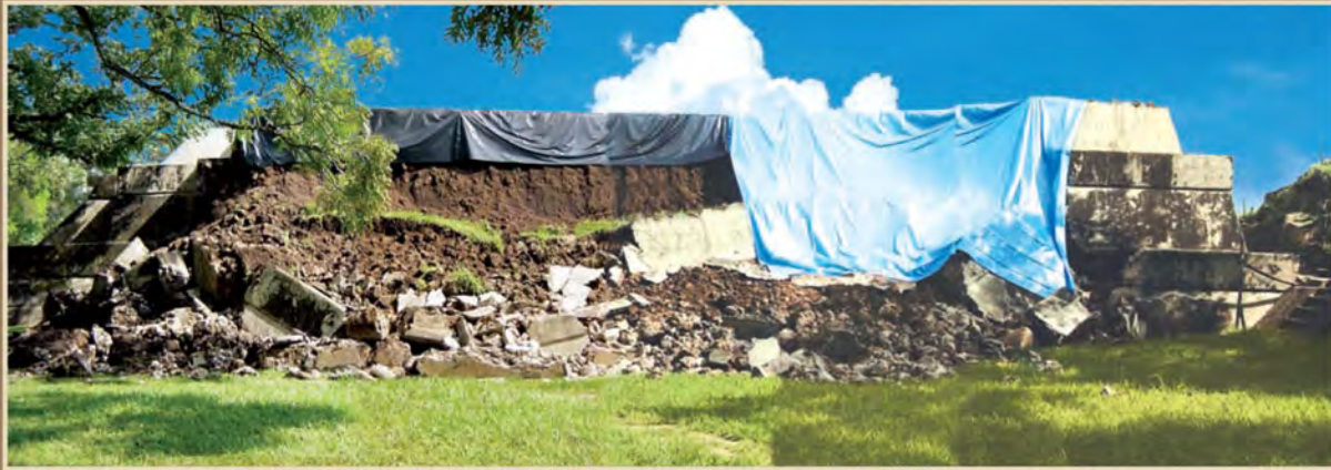
Vista general del derrumbe. Fachada sur de la estructura B1-2, El Tazumal, Chalchuapa, el 18 de octubre de 2004. Fotografía: Shinya Kato
