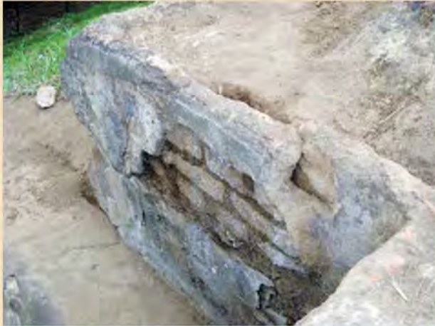
Figura 102 Vista de la parte dañada en el sector suroeste del basamento superior 1
