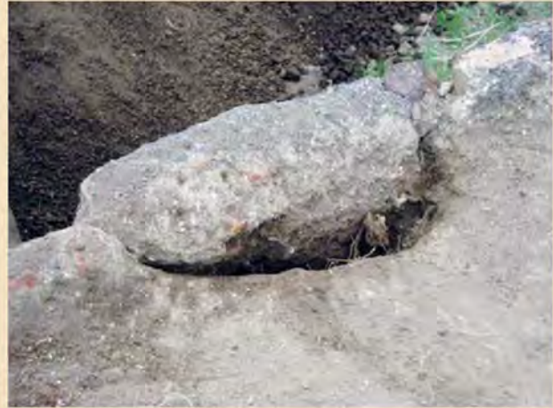
Figura 103 Vista de la parte dañada en el sector suroeste del basamento superior 2
