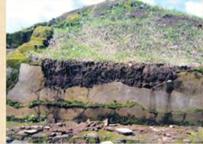
Figura 12 La pared dañada en el sector norte del basamento superior de la Estructura 5
