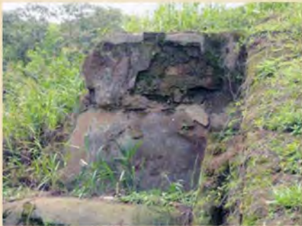
Figura 8 La pared dañada en el sector suroeste de la Estructura 5
