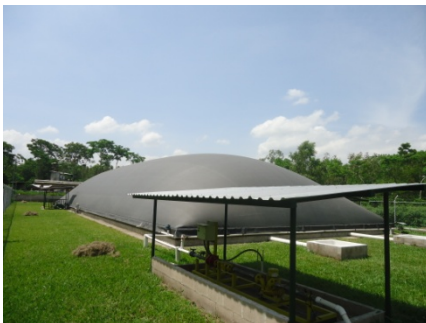
Proyecto de biogás de Agrosania Hilcasa
