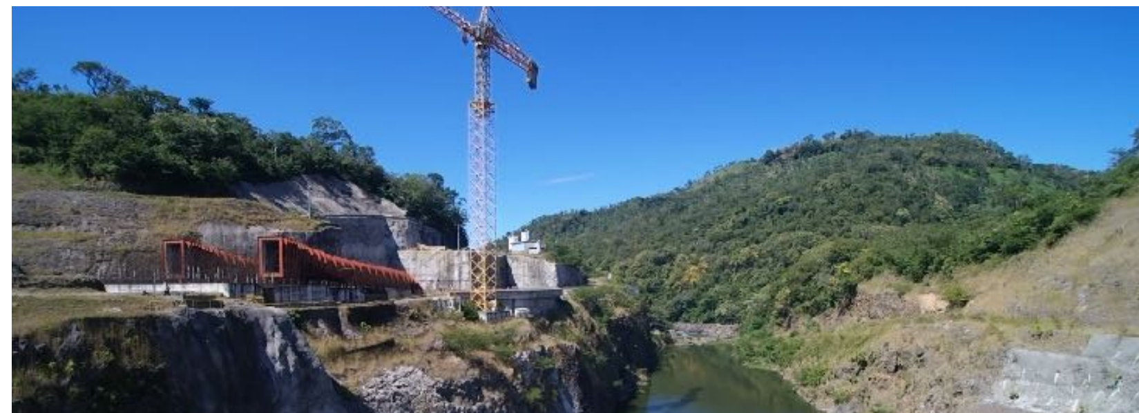
Proyecto hidroeléctrico El Chaparral
