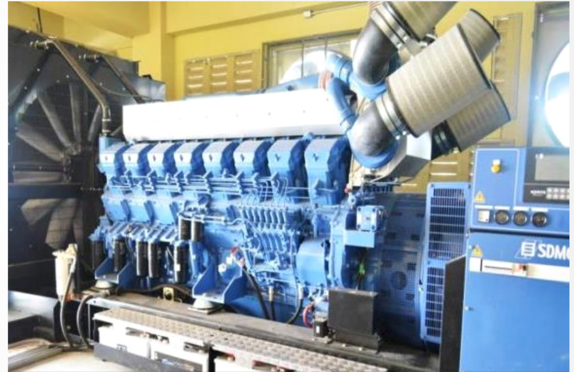
PLANTA DE EMERGENCIA DE 2,000 KVA
