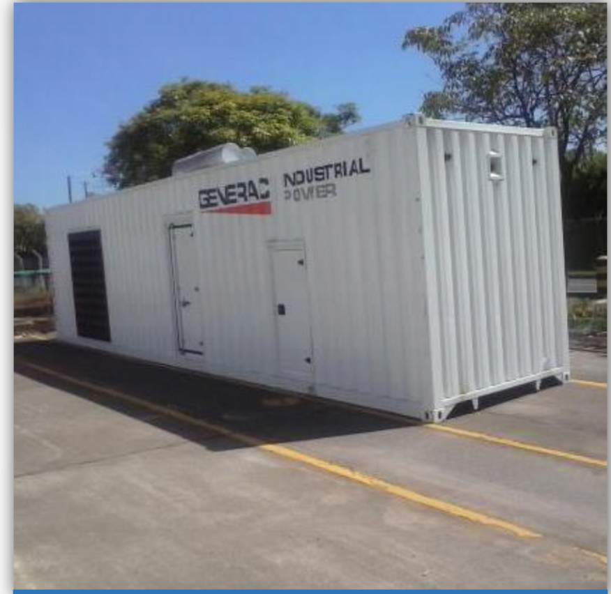
NUEVA PLANTA DE EMERGENCIA
