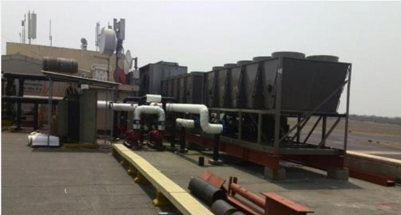
UNIDADES ENFRIADORAS DE AGUA (CHILLERS)
