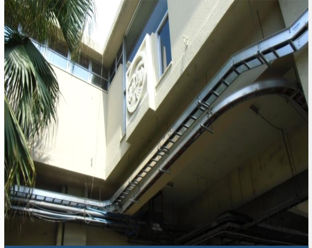
CABLE MONO-POLARES PARA UN SISTEMA TRIFÁSICO A 4,160 V
