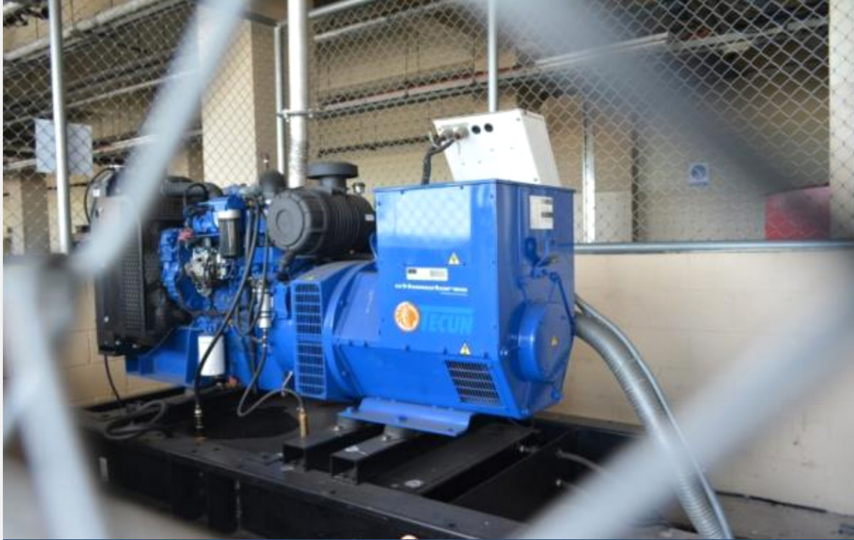
PLANTA GENERADORA ELÉCTRICA DE EMERGENCIA DE 100 KVA
