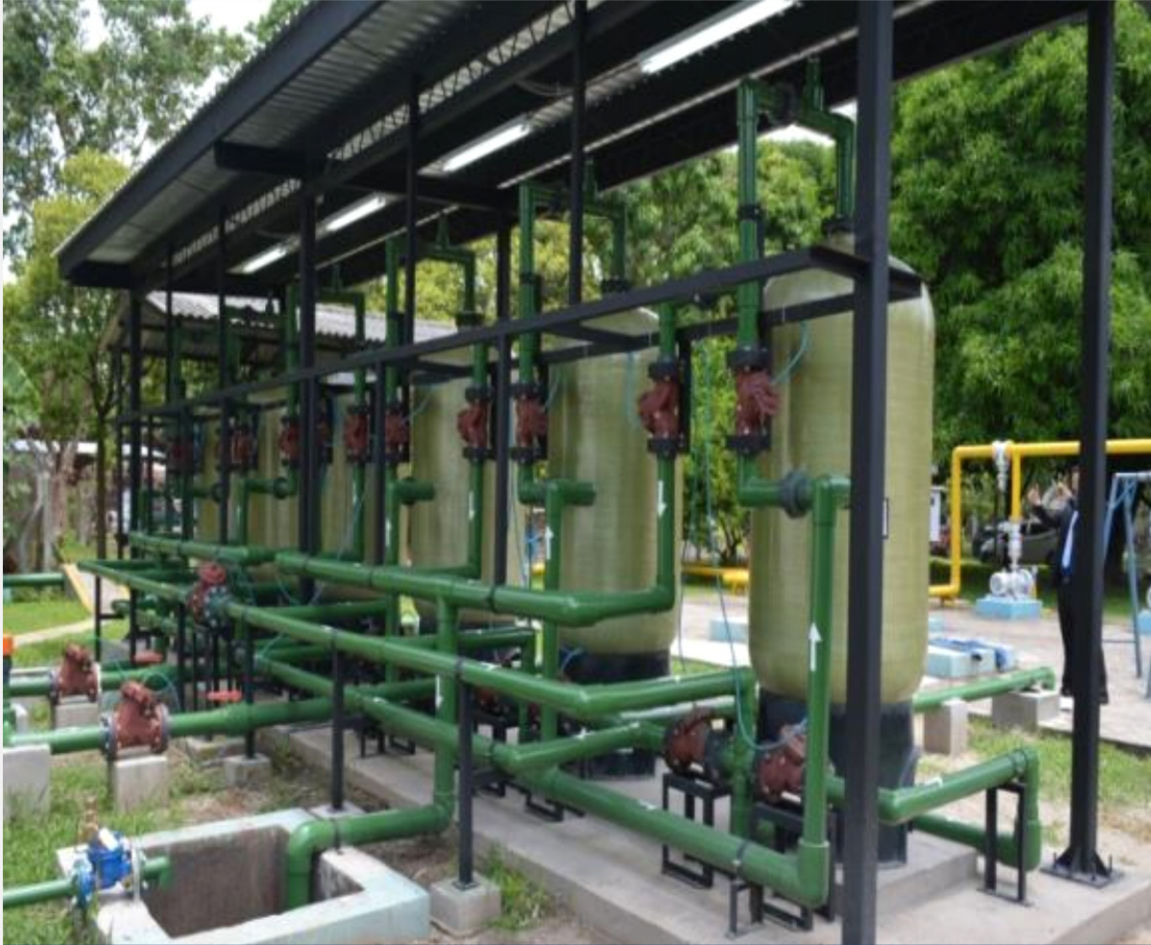
SISTEMA AUTOMÁTICOS DE POTABILIZACIÓN DE AGUA
