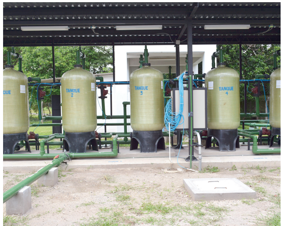
También se puso en funcionamiento dos sistemas automáticos de potabilización de agua para los pozos 1 y 2, que permite proveer de agua potable de calidad a todas las instalaciones aeroportuarias.
