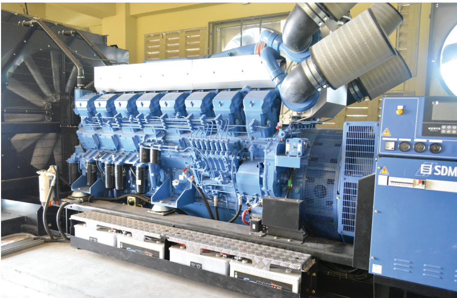
Se adquirió un grupo electrógeno de emergencia de 2,000 KVA, que permite garantizar la continuidad de las operaciones aeroportuarias y de los servicios prestados en sus instalaciones.
