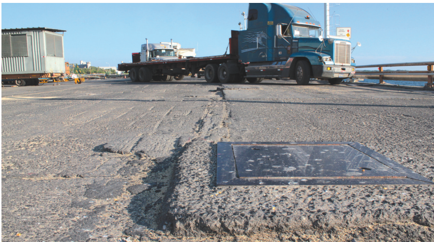
ANTES. Se colocó una capa de mezcla asfáltica convencional sobre la superficie, el espesor promedio es de 5 centímetros.
