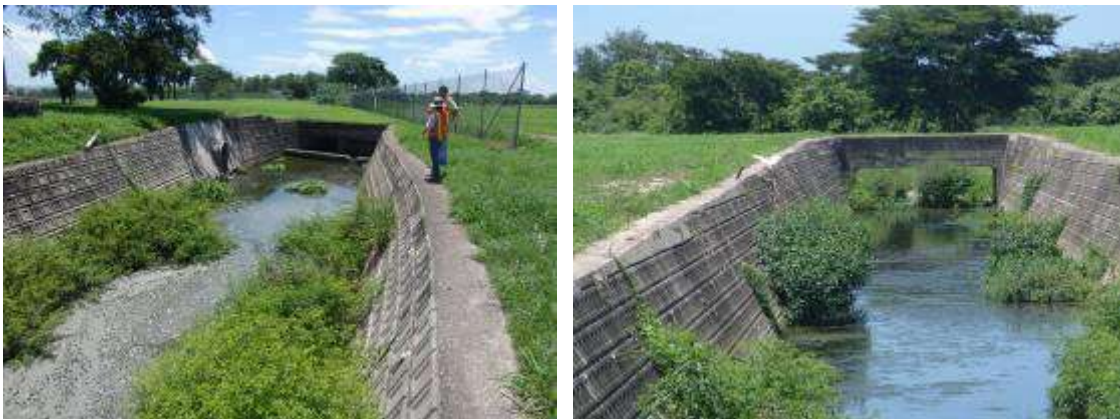
Figuras 1 y 2. Panorámicas de canaletas revestidas y con vegetación acuática tomadas en la zona noreste del aeropuerto, frente a las instalaciones de la base militar estadounidense.
