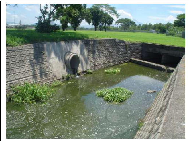
Figura 27. Estancamiento de agua en canaletas Foto: C. Dueñas
