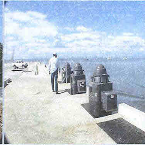
Bombas del Sistema Contra Incendios
