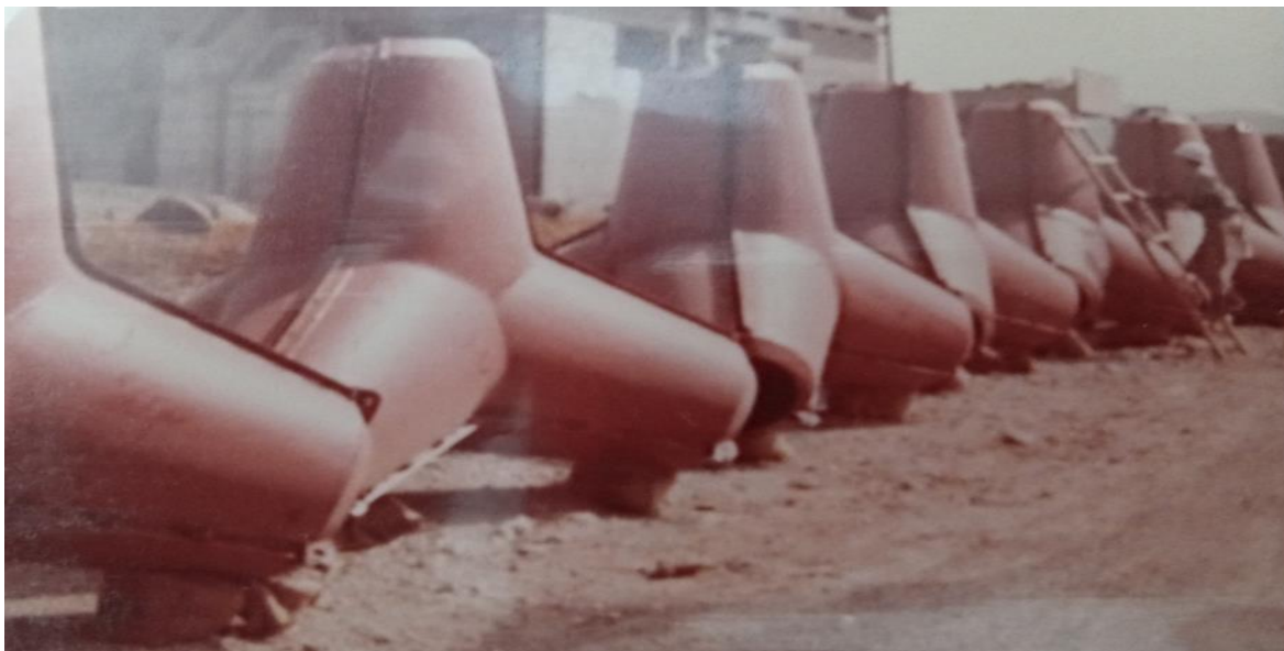
Imagen 26. Fotografías de colocación de tetrapodos de concreto que amortiguan las fuerzas de las olas en el Puerto de Acajutla, Álbumes fotográficos Archivo Central, CEPA.
