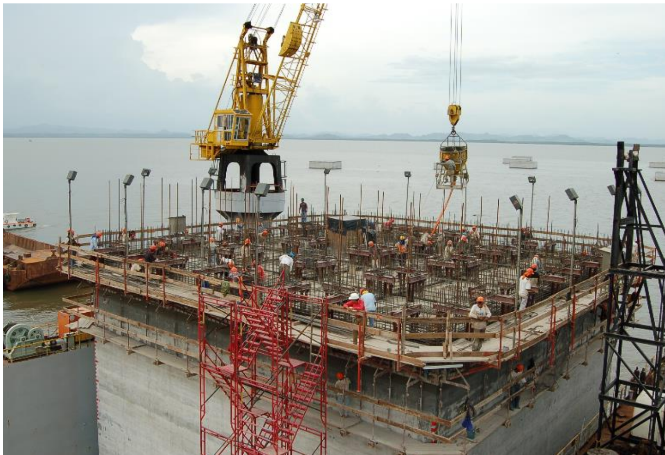
Imagen 25: Personal del contratista, realizando el molde deslizante para elaborar los cajones de concreto armado que luego serán alineados con una grúa especial en el área del muelle, 36
