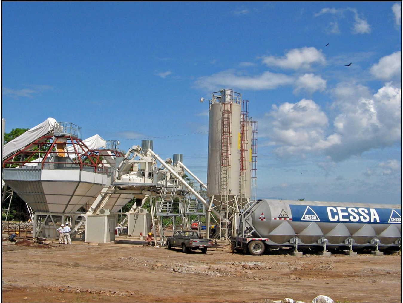
Imagen 22: Vista de la planta procesadora de concreto que fue instalada en el Puerto de la Unión, donde se realizaba las mezclas de producción de concreto en el laboratorio instalado en el sitio del proyecto, septiembre de 2005 33
