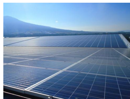
Proyecto fotovoltaico de Hilcasa
