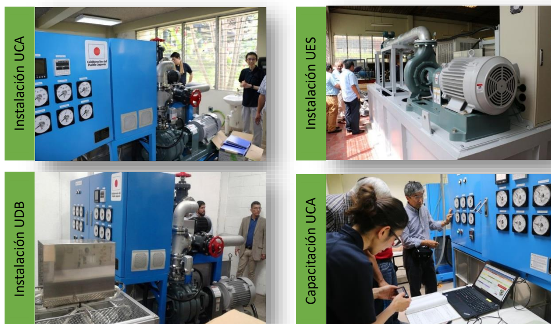
Figura No. 6. Pequeñas Centrales Hidroeléctricas instaladas en las universidades beneficiadas
