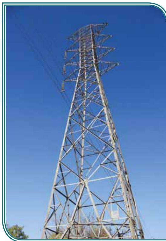
Torre de Transmisión
