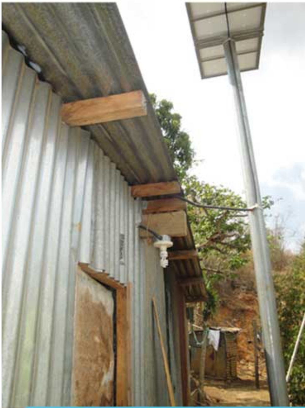
Vivienda rural beneficiada con la instalación de un Sistema Fotovoltaico Aislado, en Comasagua municipio de la Libertad
