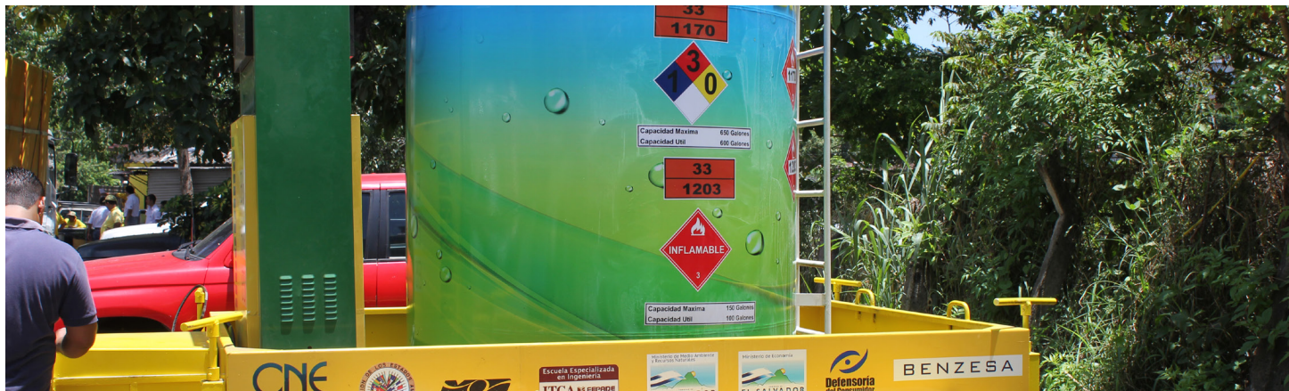
Bomba dispensadora para el suministro de Bioetanol en flota vehicular público-privada
