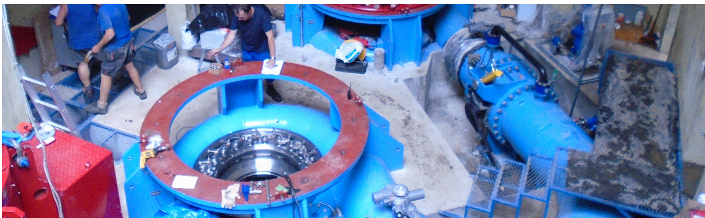
Pequeña central hidroeléctrica
