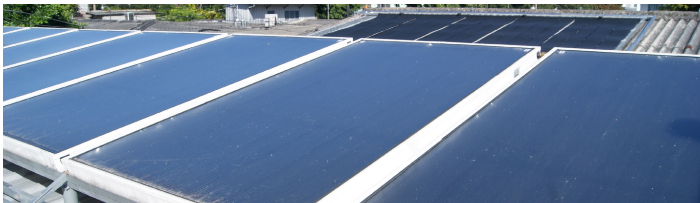
Sistema de calentamiento solar del CRINA
